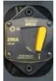
Sectionneur de Batterie et Arrêt d'urgence
